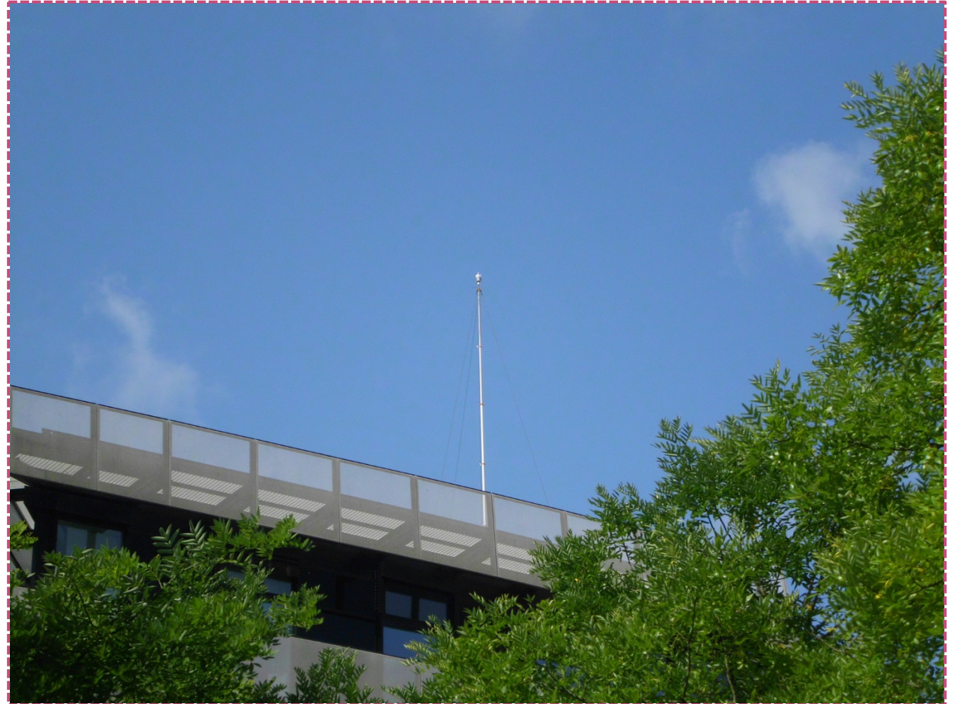
Temporäre Messinstallation auf einem Flachdach (Quelle: MI UHH).
